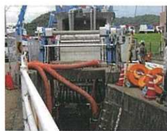
▲白滝排水機入口
